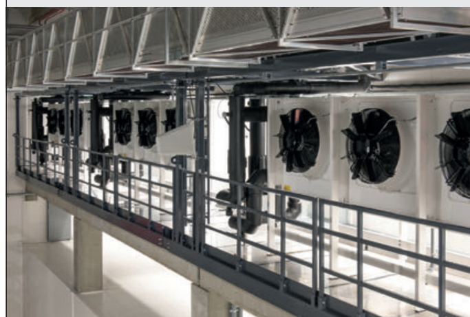
CoolLine-ilmanjäähdyttimiä SOK Sipoon logistiikkakeskuksessa
