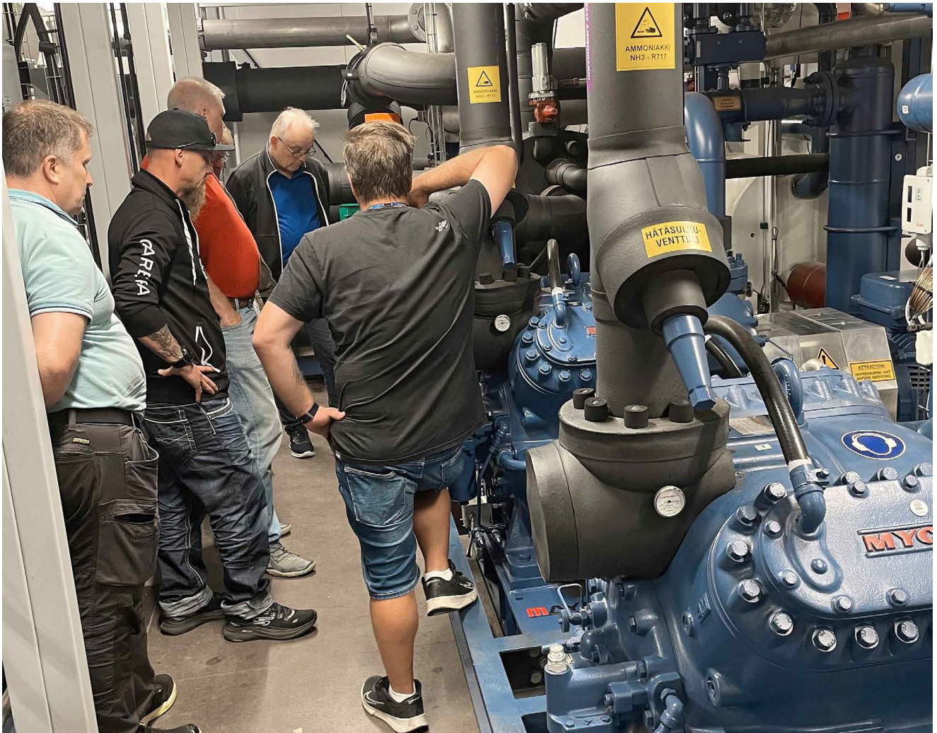
↑ Careerian opettajat perehtymässä Vantaan Hakunilan ulkotekojääradan ammoniakkikoneistoon. Kuva: Kristiina Eerola.
