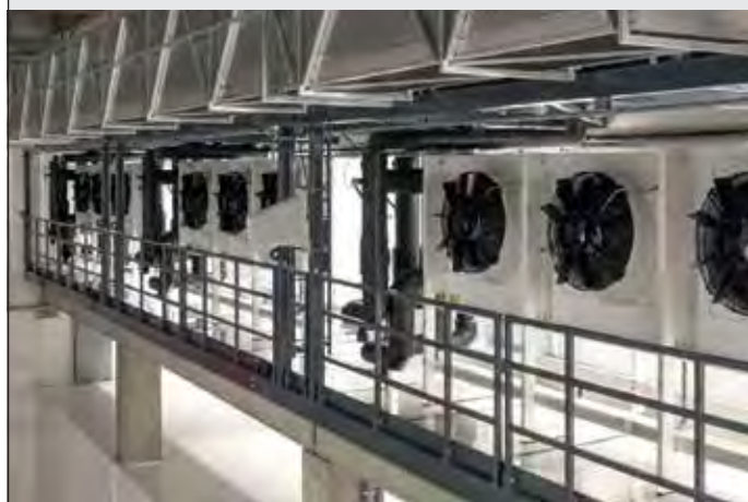
CoolLine-ilmanjäähdyttimiä SOK Sipoon logistiikkakeskuksessa
