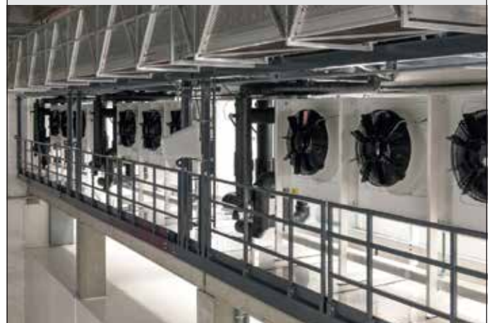
CoolLine-ilmanjäähdyttimiä SOK Sipoon logistiikkakeskuksessa
