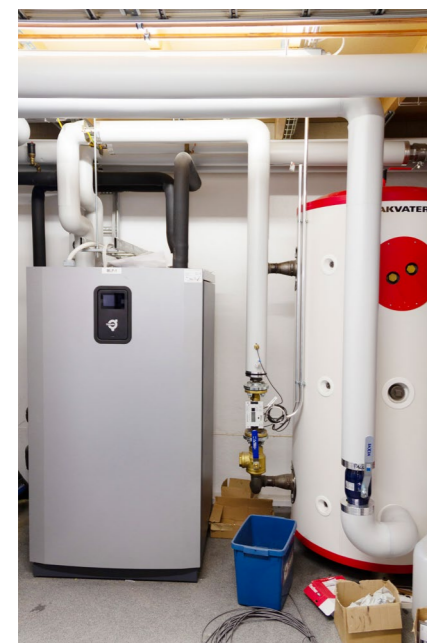
↑ Thermia Mega XL 21-88kW lämpöpumppu ja kaksi varaajaa sijaitsevat uusimman laajennuksen ”pannuhuoneessa”. Mahdollisille lisälämpöpumpulle on varaus tekniikkaparvella.
