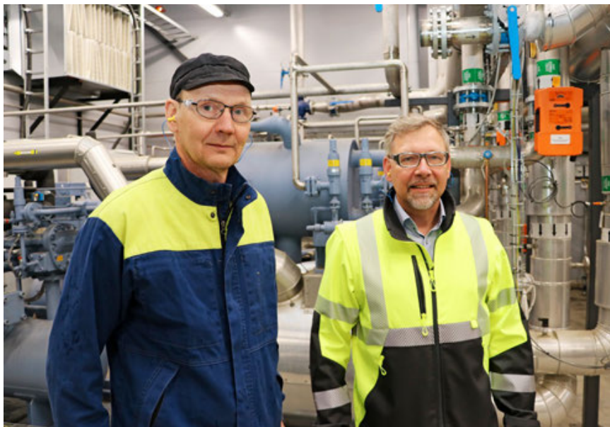
↑ Heikki Korhonen (vas.) ja Veli-Matti Tuokkuri sanovat, että uuden kylmälaitoksen myötä ammoniakkiä tarvitaan enää murto-osa entiseen järjestelmään verrattuna.
